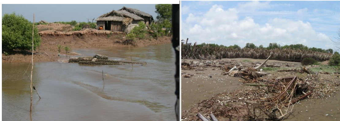
Hình 3.9: Hiện trạng xói lở bờ biển tại huyện Thạnh Phú
