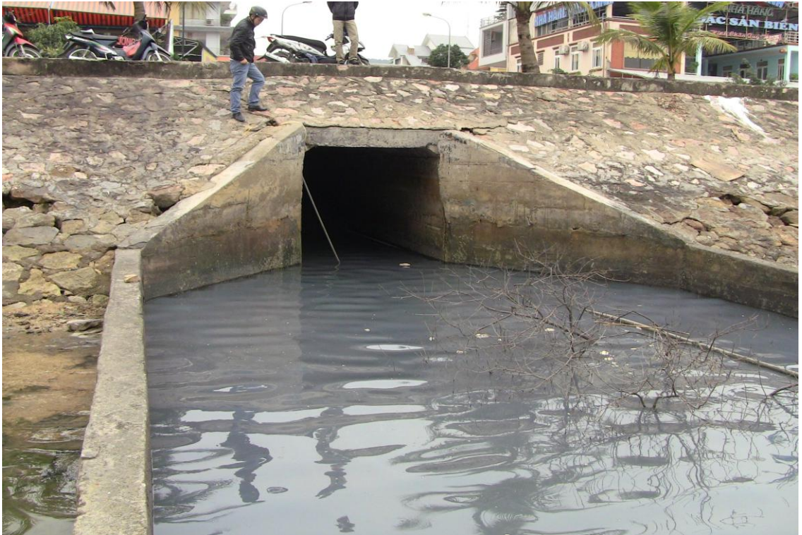
Cống nước thải sinh hoạt khu vực đô thị Lán Bè – Cột 5 đổ trực tiếp ra vịnh Hạ Long không qua xử lý năm 2013
