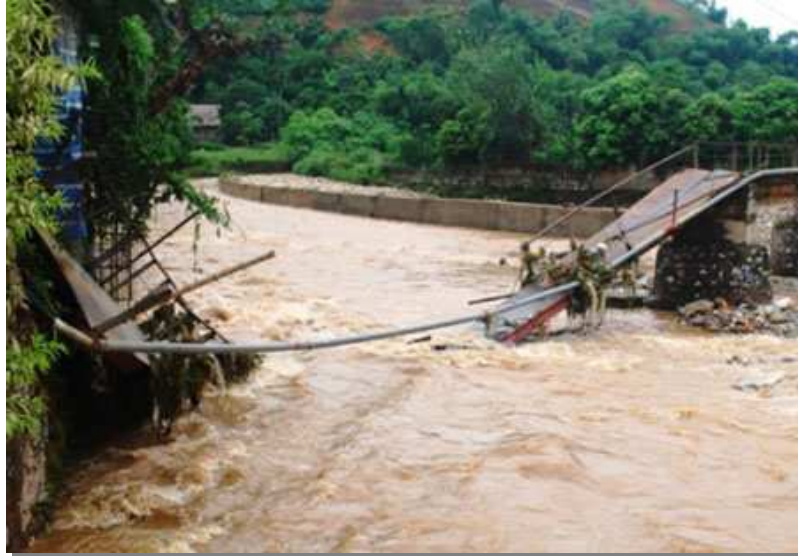
Hình 3.12. Lũ làm sập cầu qua thôn vạch 6/2014
