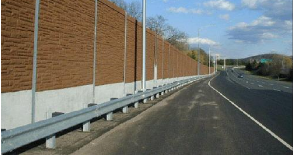
Hình 3.10. Tường chống ồn bằng bê tông
